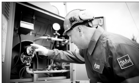
Настройка работы подогревателя газа.
