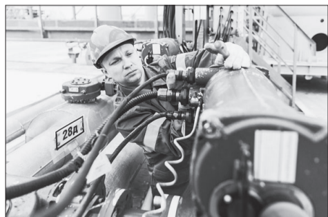
Обслуживание и настройка концевых выключателей крана.
