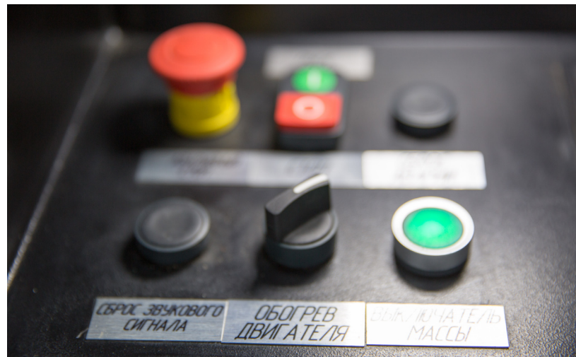
Процесс управления азотной установкой автоматизирован
