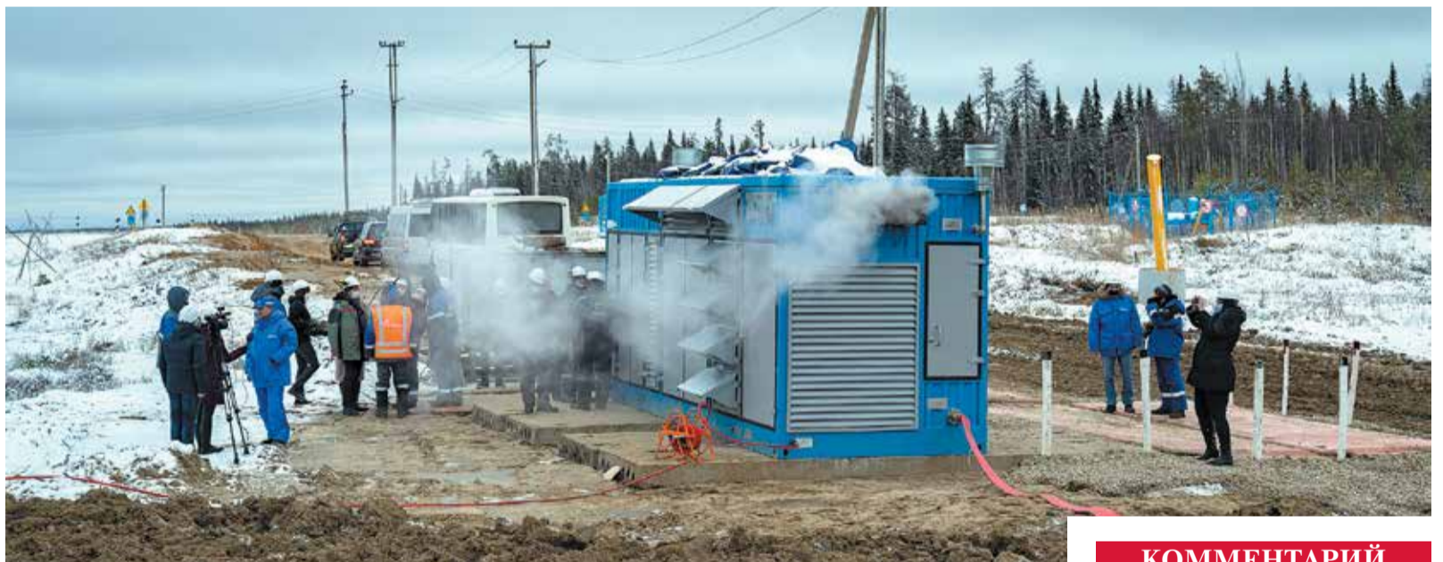
Установка производит азот с концентрацией 98%, который необходим для обеспечения безопасности при огневых работах. Фото: Евгений Грох
