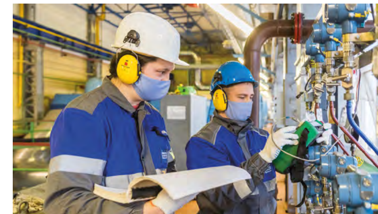
Виталий Мальцев и Сергей Болотовский, специалисты службы автоматизированных систем управления, автоматике и телемеханики Сосногорского ЛПУМГ, выполняют проверку каналов измерения на ремонтном газоперекачивающем агрегате
