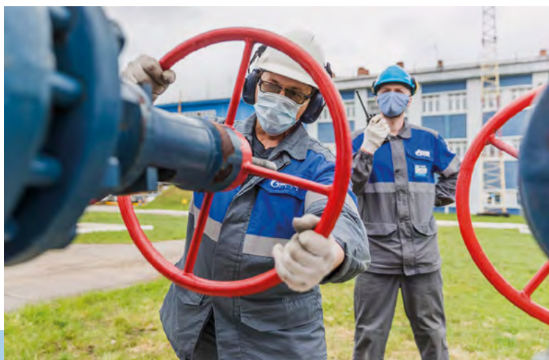
Валерий Скалкин, машинист технологических компрессоров газокомпрессорной службы Сосногорского ЛПУМГ, производит перестановку запорной арматуры в обвязке технологического оборудования
